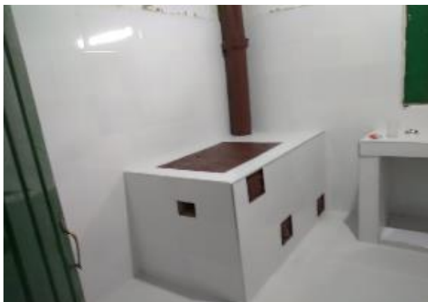
Foto 3. Enchape de piso y paredes en cocina
